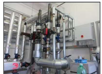
Foto-4: Gebäudeanschluss Nahwärme
